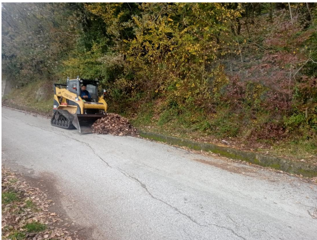
FOTO N° 16 Sistemazione viabilità rurale e ripulitura cunetta "loc. Retarella" – Cantiere Moio della Civitella
