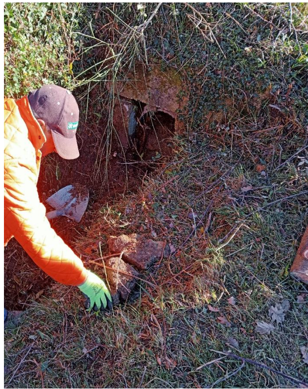
FOTO N° 15 Sistemazione viabilità rurale mediante la ripulitura di tratti intubati "loc. Casa Antica" – Cantiere Perito
