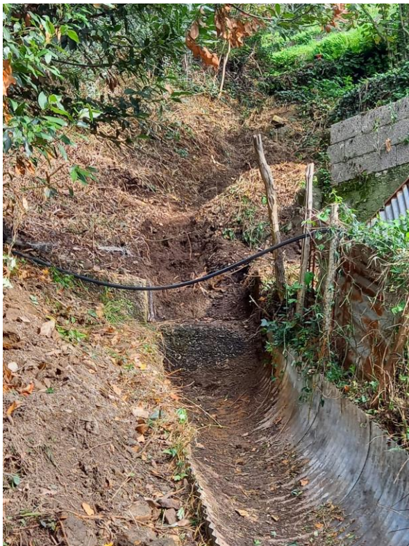
FOTO N° 14 Sistemazione viabilità rurale mediante la ripulitura di tratti intubati "loc. S. Nicola" – Cantiere Orria
